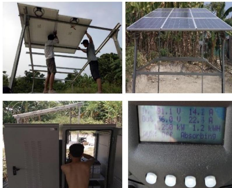
Gambar 5. Pemeriksaan Over Voltage
